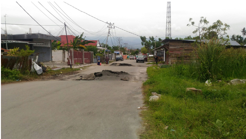
Gambar 1. Kerusakan akibat surface rupture
