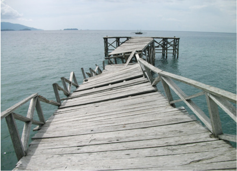
Gambar 8. Guncangan gempa bumi dan juga tsunami tanggal 28 September 2018 mengakibatkan kerusakan dermaga di Kampung Tanah Runtuh, Kecamatan Balaesang, Kabupaten Donggala.
