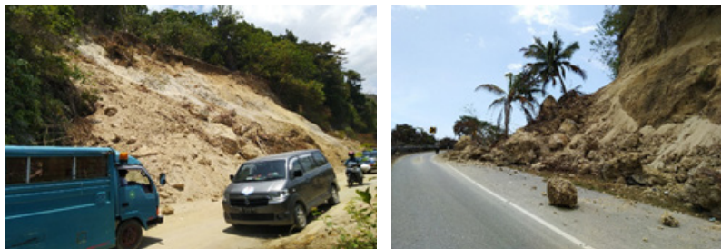
Gambar 10. Potensi longsor susulan dan jatuhan batu yang membahayakan pengguna jalan pada ruas jalan Palu – Toli-Toli
