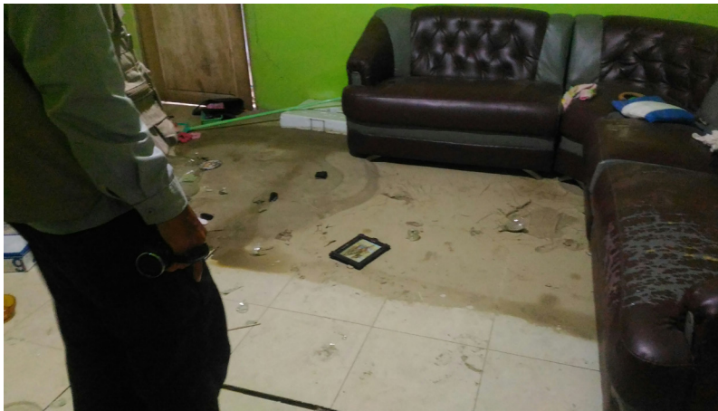
Gambar 2. Bangunan yang terkena dampak likuifaksi
