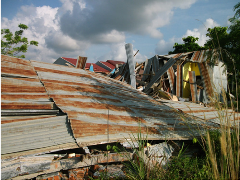
Gambar 9. Rumah penduduk roboh di Kota Pasangkayu akibat gempa bumi tanggal 28 September 2018.
