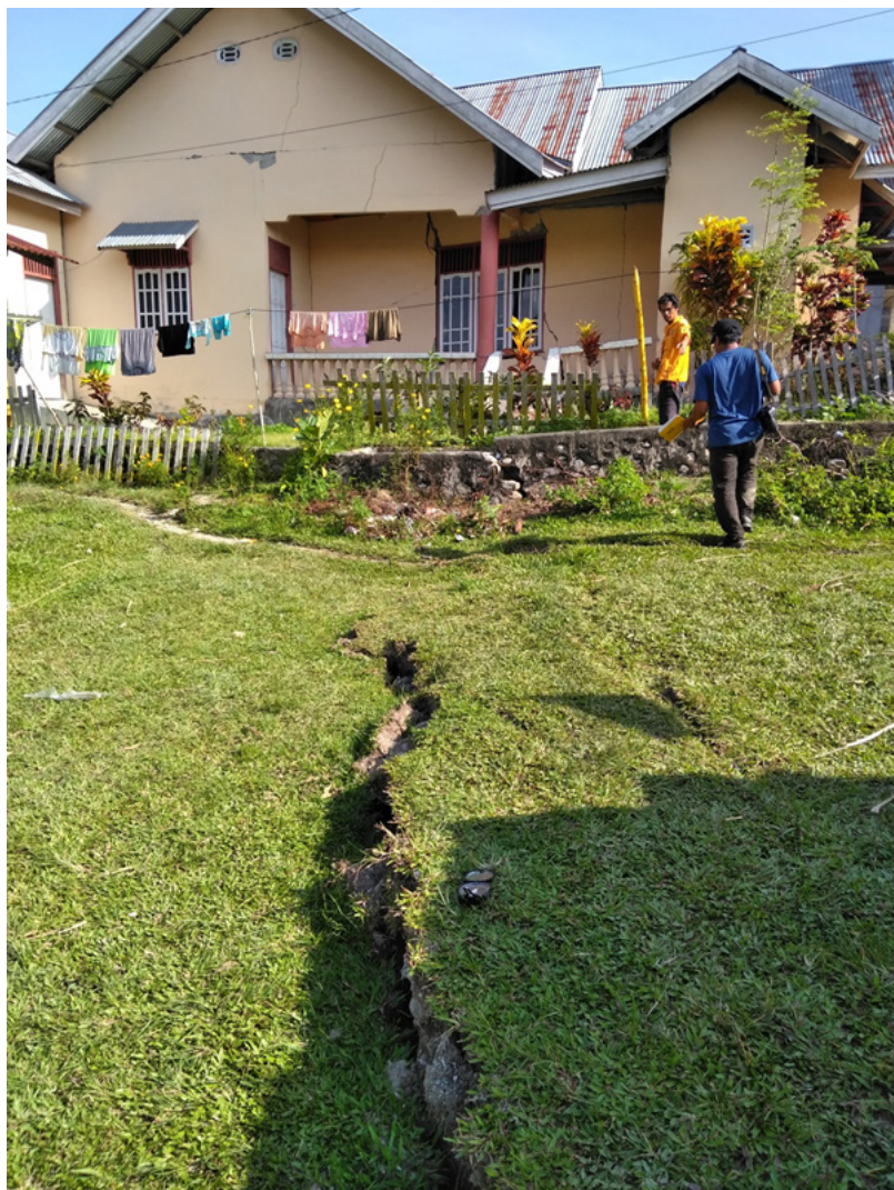
Gambar 10. Sesar permukaan berbentuk merengong mengakibatkan kerusakan rumah penduduk di desa Bolapapu, Kulawi, Kabupaten Sigi. Besarnya pergeseran mengiri di lokasi ini 35 cm.
