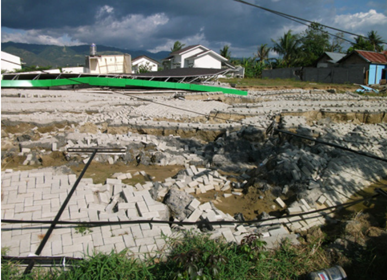
Gambar 7. Retakan tanah masif berarah utara – selatan mengakibatkan kerusakan bangunan di daerah Jono Oge, Kecamatan Sigi Biromaru, Kabupaten Sigi akibat gempa bumi 28 September 2018.
