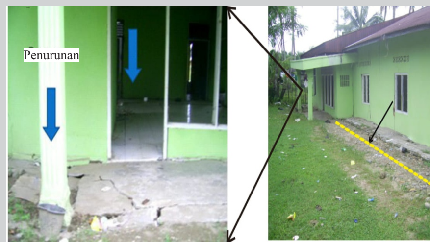
Contoh penurunan permukaan tanah pada pondasi rumah di Padang Kandang akibat gempa Padang 30 September 2009
