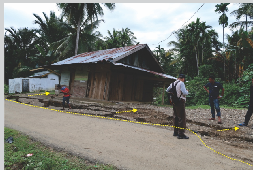
Contoh pergeseran lateral pada tanah permukaan akibat gempa Pidie, Aceh 7 Desember 2016
