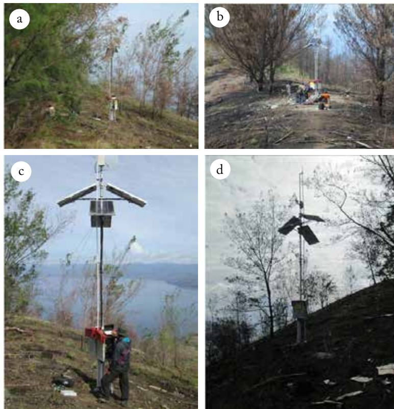
Gambar 4.186 Stasiun kegempaan dan deformasi yang berhasil dibangun di G. Iya pada bulan Desember 2014. Berturut-turut adalah (a) stasiun Iya 1; (b) stasiun Iya 2; (c) stasiun Iya 3 dan (d) stasiun Iya 4.
