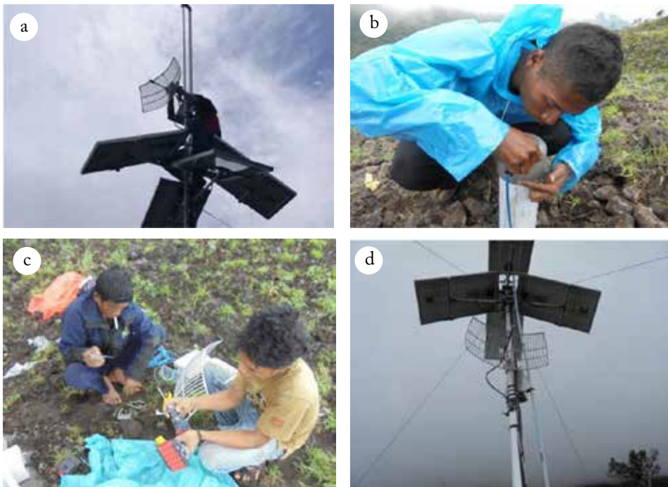
Gambar 4.184 Foto kegiatan instalasi di Stasiun 1. a. Penggantian arah antenna ke arah Pos PGA Ine Rie. b. Kabel seismometer dilapisi dengan silikon agar terlindung dari air dan panas. c. Persiapan pemasangan antenna dan radio broadband sebagai penerima dari Stasiun 2. d. Antenna dan radio sebagai penerima dari Stasiun 2.
