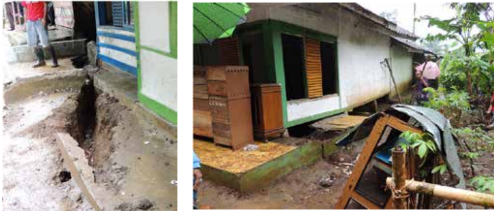
Gambar 4.161 Retakan yang terjadi di pemukiman Desa Sukarasa, Kecamatan Salawu, Kabupaten Tasikmalaya. Gerakan Tanah ini mengakibatkan 5 rumah rusak dan 20 rumah terancam.
