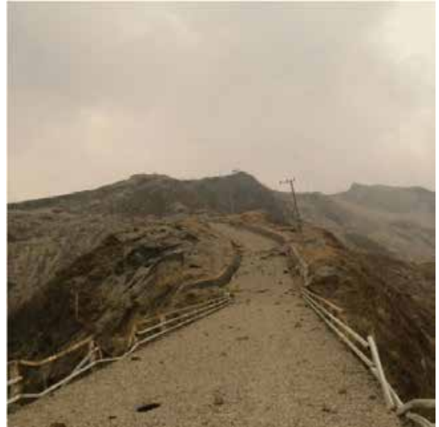
Gambar 4.169 Kondisi sarana jalan dan jembatan menuju puncak G. Kelud nampak rusak dan tertimbun material vulkanik terkena dampak erupsi 13 Februari 2014. Foto. 16 Februari 2014/Umar/PVMBG
