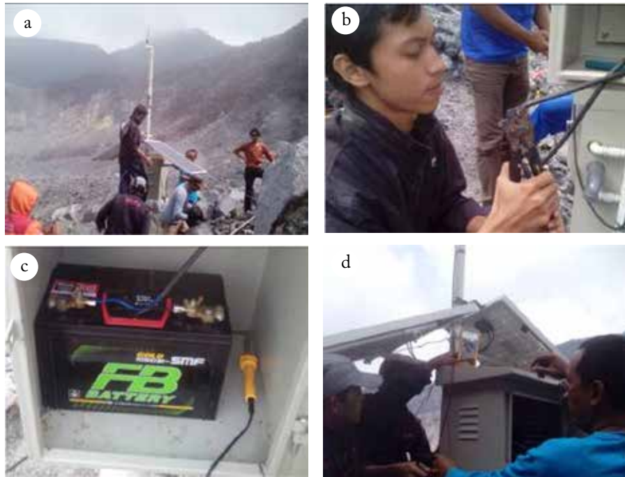
Gambar 4.176 Proses instalasi sistem catudaya stasiun lapangan. A. Pemasangan 2 unit solar panel 80 WP, b. Pemasangan kabel solar panel. C. Pemasangan 1 unit aki 105 Ah dalam boks panel. D. Pemeriksaan tegangan solar panel dalam kondisi dipasang.
