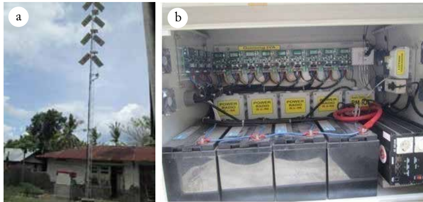
Gambar 4.185 Sistem power mandiri yang dibangun di Pos Pengamatan G. Iya. (a) 12 unit solarpanel 80 watt dipasang pada tower triangle 8 stick di halaman samping pos pengamatan; (b) sistem power yang terdiri atas 4 unit aki 12 volt 100 ah, 12 regulator solarpanel 10 A dan 1 unit inverter 3000 watt.
