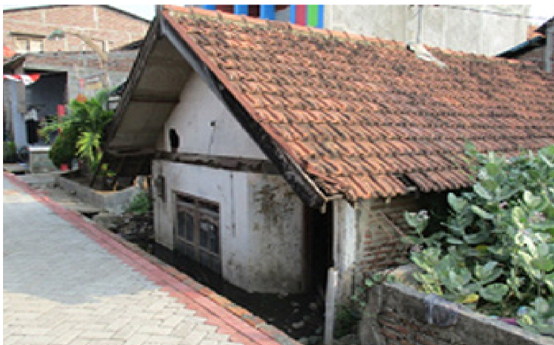
Foto 1. Rumah-rumah yang mengalami penurunan tanah, dengan posisi lebih rendah daripada jalan yang berada di daerah Purwosari (kiri) dan Bandarharjo (kanan).
