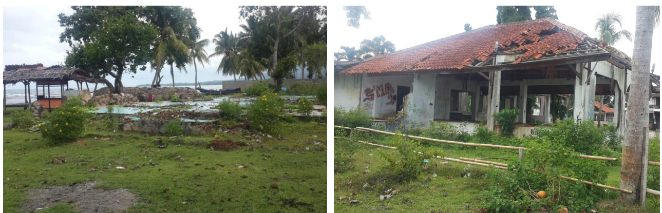
Gambar 38. Kerusakan pada bangunan di Pantai Paradise, Belakang Hotel Mutiara, Desa Banjarmasin, Carita, Banten, akibat tsunami 22 Desember 2018 (Yudhicara, et al. , 2020)
