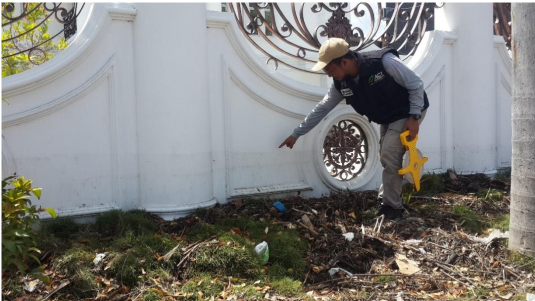
Gambar 74. Efek genangan tsunami pada dinding pagar bangunan (Yudhicara et al. , 2018)
