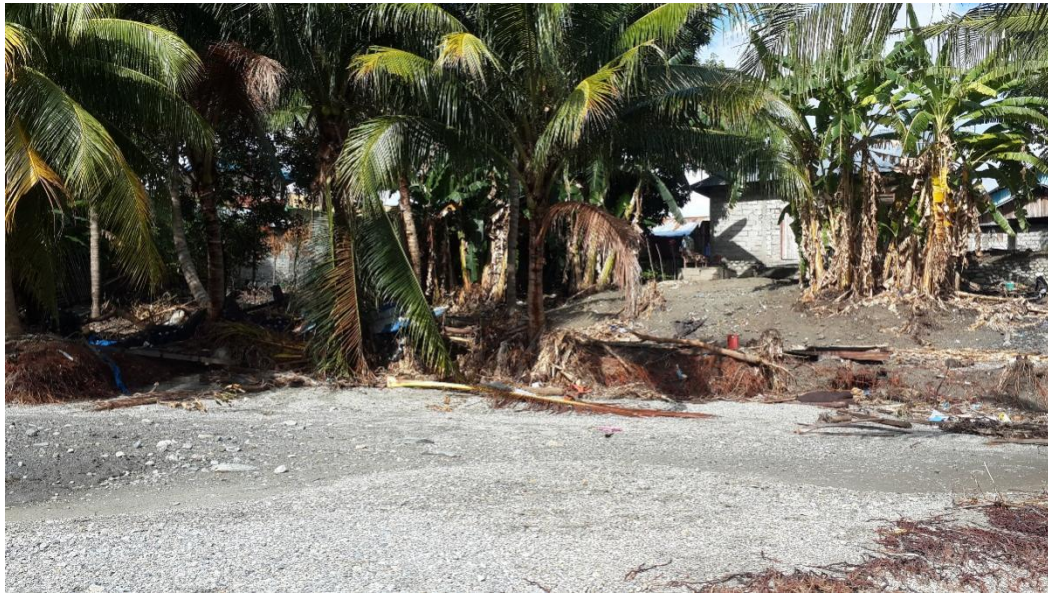
Gambar 70. Indikasi undak pantai akibat penurunan ( subsidence ) setinggi 0,62 m (Yudhicara, et al. , 2018)
